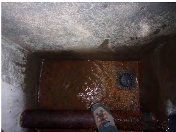
Bac de pied sec parfois humide lors du fonctionnement du trop plein du bac de prise
