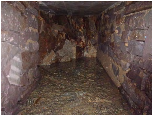
Ouvrage empierré avec arrivée d'eaux souterraines situées dans la zone d'affleurement du granite
