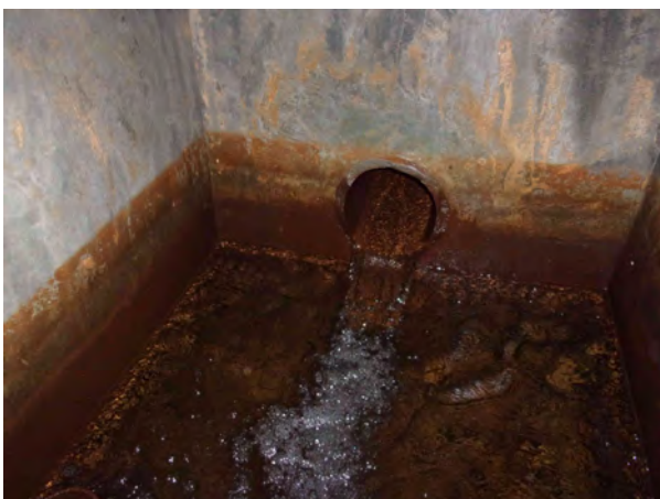
Arrivée des eaux traitées dans le répartiteur
