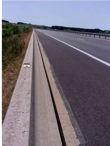
Caniveau sur l'autoroute permettant de collecter les eaux de la plateforme autoroutière. Ces eaux sont acheminées vers des bassins de décantation à l'extérieur du bassin de Font des Rases
