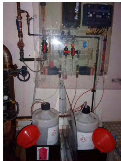
Dispositif de désinfection des eaux
