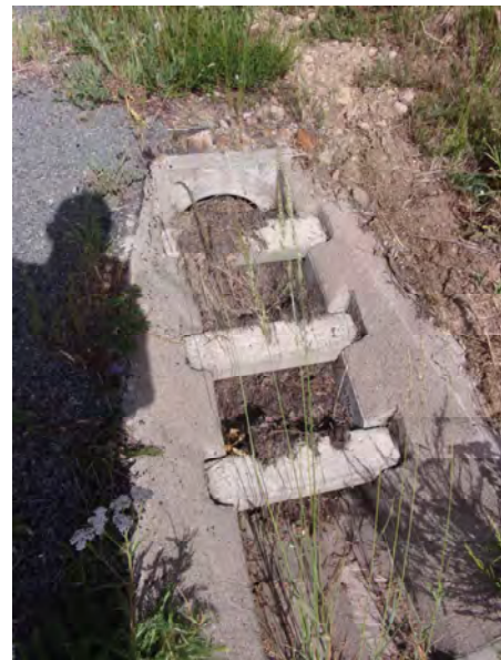
Buse colmatée à déboucher
