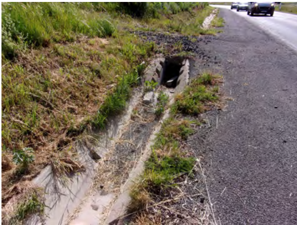
Partie du caniveau à réhabiliter rapidement
