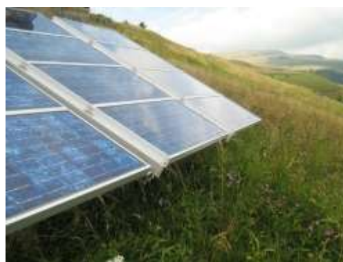
Production d'énergie photovoltaïque au sol © SMPNRVA
